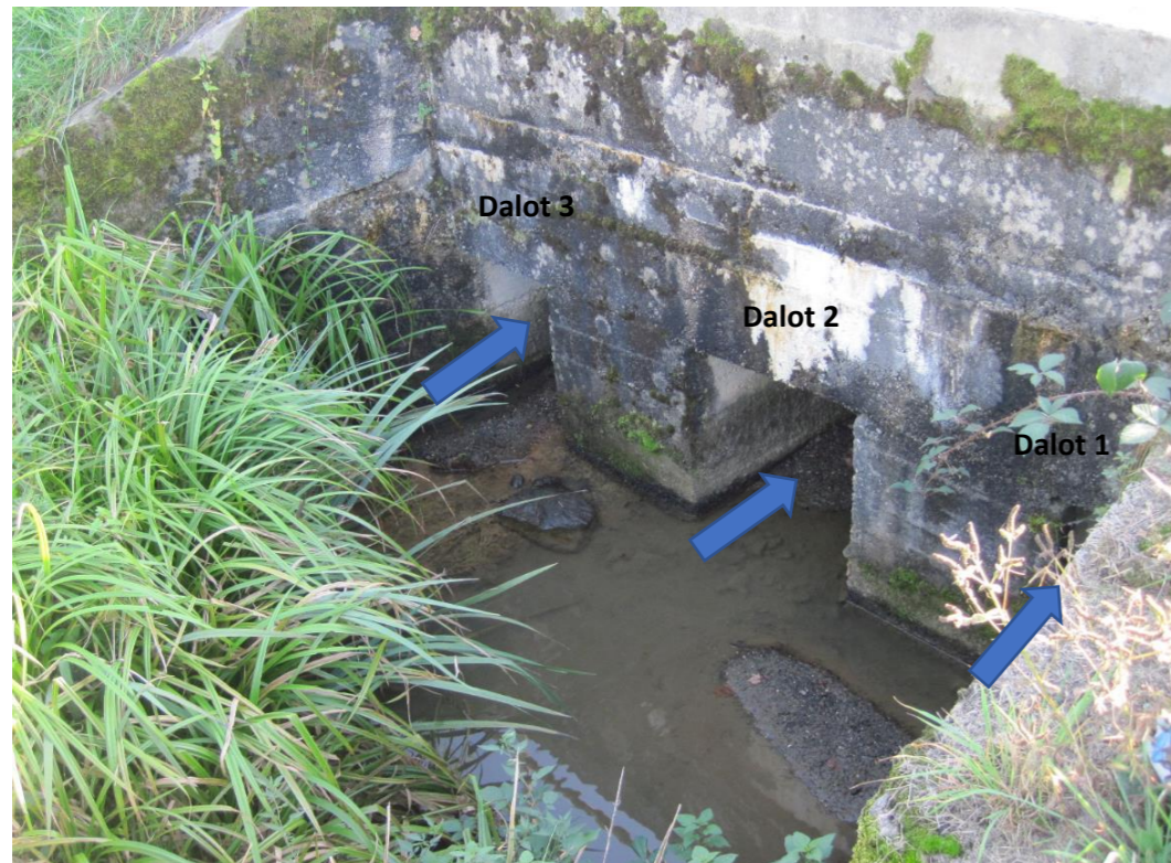
Ouvrage F : Ouvrage sous la RD 148 en aval de plan d'eau de la Vézènie constitué de 3 dalots
