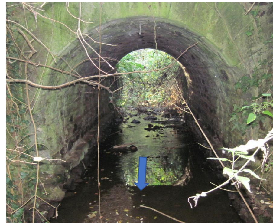
Ouvrage G : Ouvrage sous la route de Faraud : ouvrage voute (Hauteur 1.9 m, largeur : 2 m)
