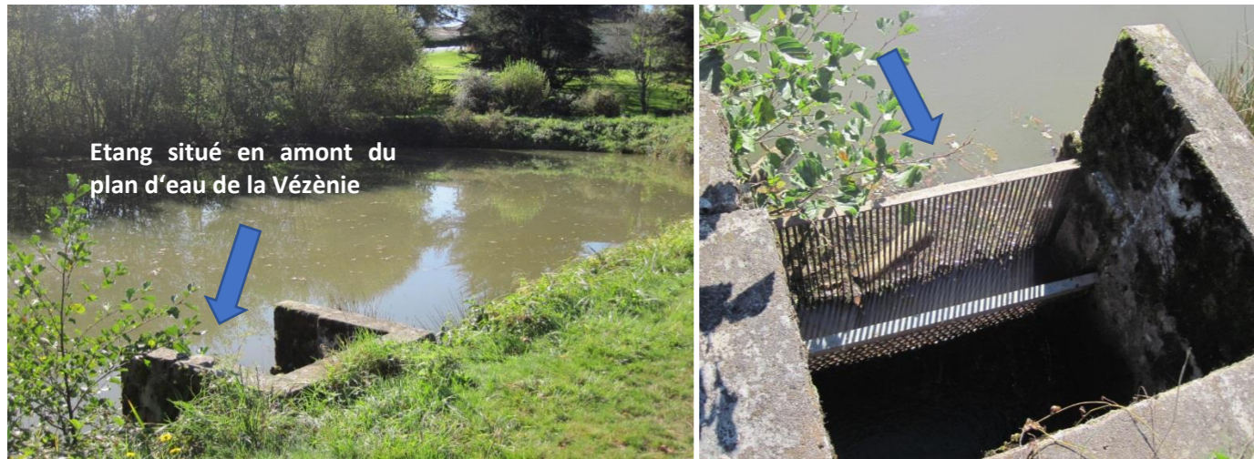
Ouvrage E : Dégrilleur et conduite Ø600 mm situé sous un chemin en amont du plan d'eau de la Vézènie.
